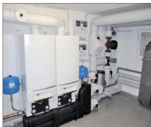
Heizstation Stöntzcher Straße in Pegau
